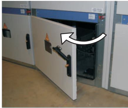
Открытие дверей отсека кабелей
