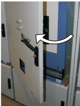
Открытие дверей отсека выкатного элемента
